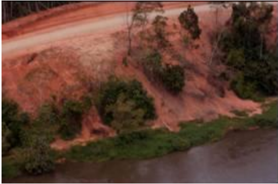
Figure 37 : point critique dû à l'instabilité de la pente et au processus d'érosion en cours
