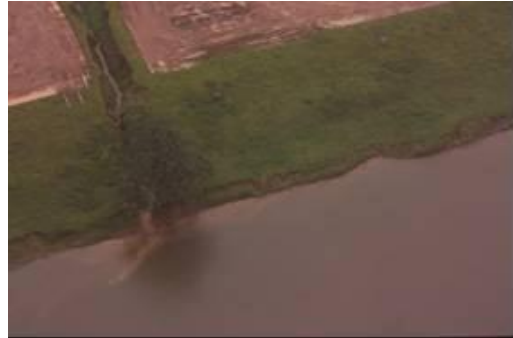
Figure 46 : point critique dû à la sédimentation du système de drainage de la route
