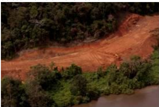
Figure 43 : point critique dû à l'instabilité de la pente
