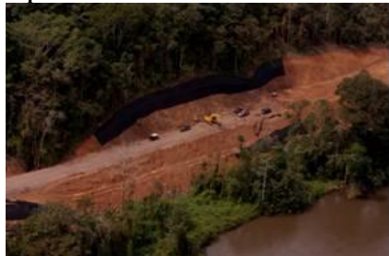
Figure 42 : point critique dû à l'instabilité de la pente
