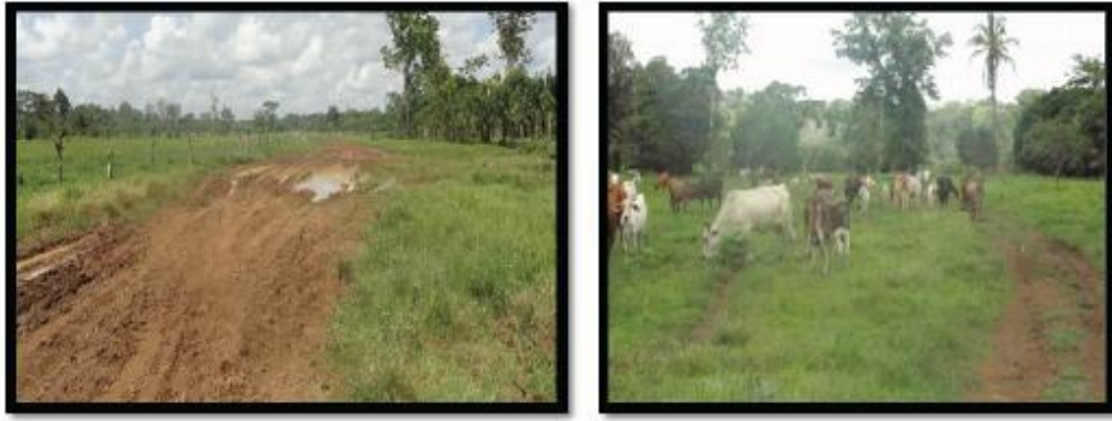
F15. Portion d'environ 10 kilomètres, principalement composée de chemins reliant des placettes ; le transit sur cette route est très difficile, même avec un 4x4.
