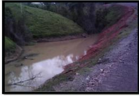
F34. Eaux stagnantes sans système de drainage d'aucune sorte.
