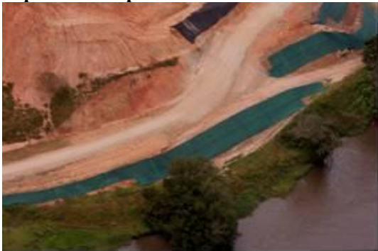
Figure 39 : point critique dû à l'instabilité de la pente et au processus d'érosion en cours
