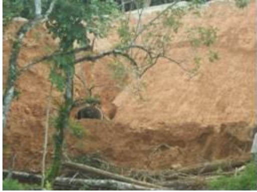
Figure 13 : ponceau d'un diamètre inférieur aux recommandations Source : mission technique
