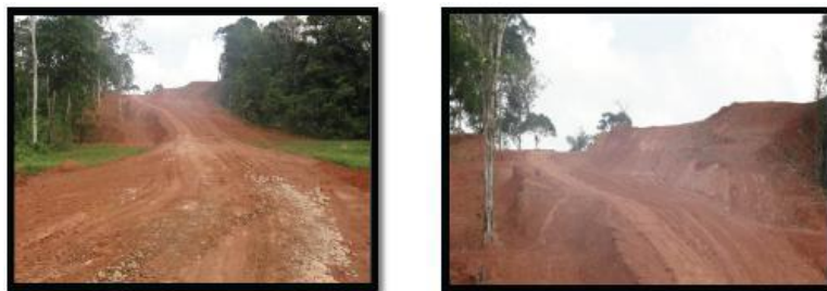
F14. Route en terre battue sans système de drainage : en l'absence de plans, les remblais et déblais ont été réalisés de manière totalement désorganisée.
