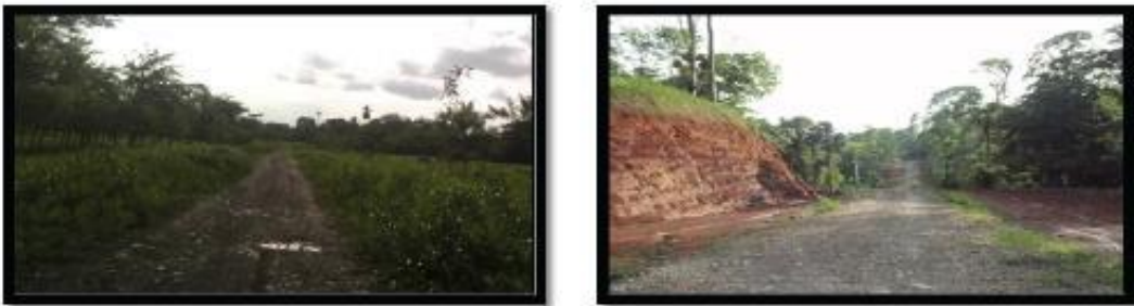
F6. La route est dépourvue de systèmes de drainage. Elle est parsemée de trous et fissures, ainsi que des zones encombrées de blocs surdimensionnés inadéquats pour les routes.
