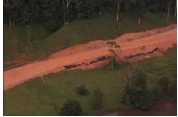
Figure 30 : l'accélération de l'érosion entraîne la dégradation des revêtements recouvrant les pentes
