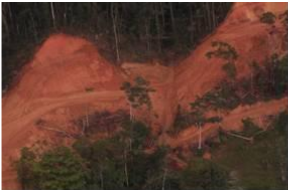
Figure 49 : point critique dû à l'instabilité de la pente
