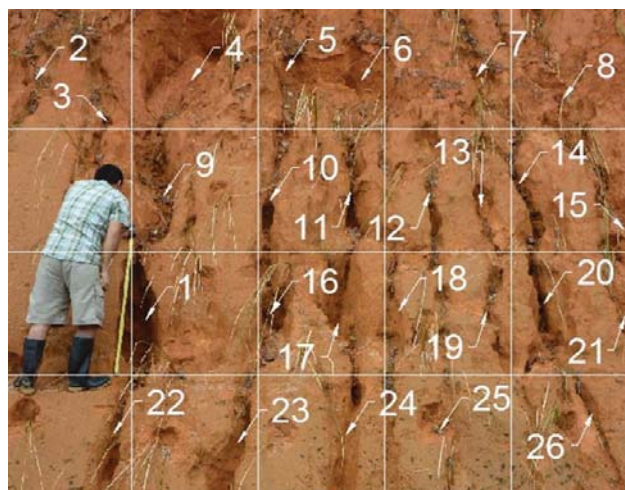
Figure 30. Site d'observation de l'érosion en rigoles d'un talus de déblai, avec numérotation des rigoles et superposition d'un quadrillage dont chaque cellule représente un mètre carré (rapport de l'UCR).
