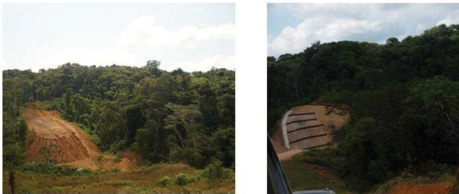
Figure 44. Couloir défriché en vue de la construction de la plate-forme de la route à proximité de Crucitas, à l’est de l’Infiernito a) le 15 février, alors que le ruissellement non contrôlé en provenance de ce couloir avait causé une érosion en nappe et en rigoles ; b) le même site le 7 mai 2013, après la mise en œuvre de mesures intégrées de gestion du ruissellement, soit notamment des travaux de déblai et de remblai, l’installation de clôtures anti-érosion et le creusement d’une rigole extérieure bétonnée. Photographies prises par l’auteur.
