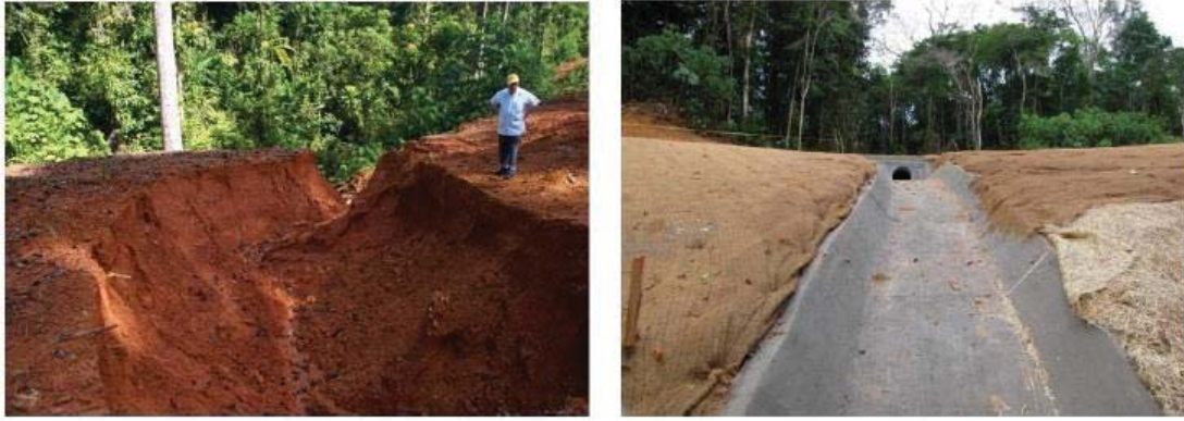
Figure 40. Vue d'une large ravine creusée dans un prisme de remblai par le ruissellement concentré de la route en direction du territoire costa-ricien, à l'ouest de la borne II a) en février pendant sa formation et b) en mai après que la ravine a été remblayée et stabilisée au moyen d'un ponceau transversal et d'une canalisation bétonnée, et le talus de remblai environnant protégé contre l'érosion en nappe et en rigoles par un tapis de fibre de coco. Photographies prises par l'auteur.
