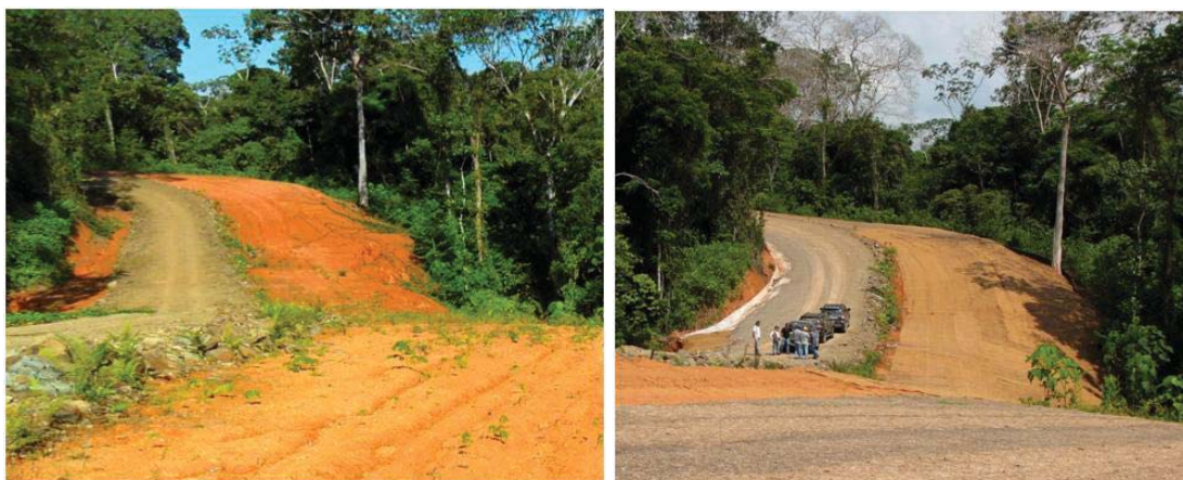
Figure 2.3 : La route près de la borne n° II, a) avant les travaux d'atténuation le 15 février 2013 et b) le 7 mai 2013 après l'exécution des travaux 119 .
