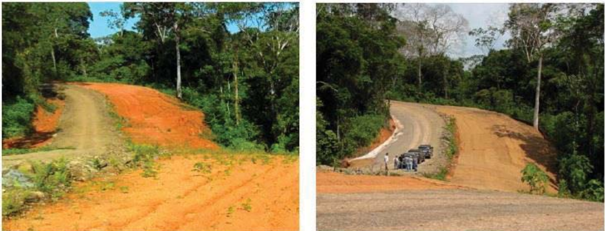
Figure 39. Vue de la route à proximité de la borne II a ) avant les travaux d'atténuation le 15 février 2013 et b ) le 7 mai 2013 après les mesures d'atténuation, soit l'installation de la canalisation d'écoulement interne et de tapis biodégradables anti-érosion. Photographies prises par l'auteur.
