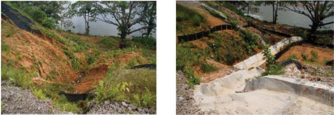
Figure 42. Partie de la route située aux coordonnées 498072 de latitude est et 325345 de longitude nord, à 6,6 km environ à l'est de la borne II a) le 15 février 2013, où l'on voit un réseau de ravines sur le talus extérieur et une accumulation de sédiments formant un dépôt sur la surface plane de la terrasse séparant le pied du talus de la rive du fleuve San Juan, et b) le 7 mai 2013, après la réalisation de travaux d'atténuation, à savoir la construction de fossés bétonnés et de chutes de niveau pour acheminer l'eau de ruissellement provenant de la plate-forme de la route, et de clôtures anti-érosion pour protéger le talus de l'érosion en nappe et en rigoles et empêcher les sédiments provenant de la route d'atteindre la terrasse. Une trappe à sédiments a aussi été construite en aval du système de rigoles pour empêcher les sédiments d'atteindre le fleuve, bien que cet élément ne soit pas facilement visible sur la photo. Photographies prises par l'auteur.
