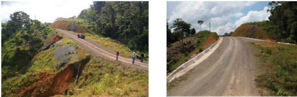
Figure 41. La route au point de coordonnées 497867 de latitude est et 325463 de longitude nord, à 6,4 km environ à l'est de la borne II a) le 15 février lorsque, par suite de la défaillance de la protection géotextile du talus, le ruissellement concentré de la route vers l'extérieur avait entraîné la formation de deux ravines, et le ruissellement vers l'intérieur l'érosion d'un talus de déblai et b) le 7 mai 2013, après la construction de deux rigoles bétonnées, l'une intérieure et l'autre extérieure. Photographies prises par l'auteur.
