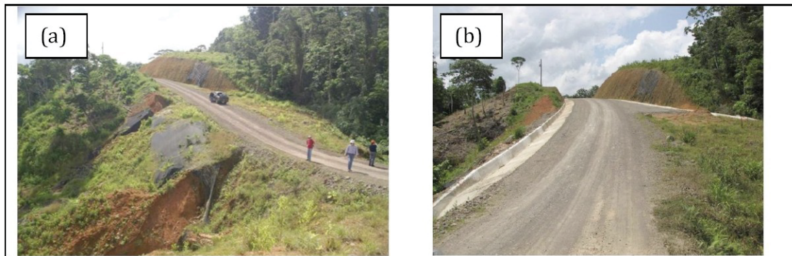
Figure 15. Route à proximité de Tiricias a) le 15 février lorsque la défaillance de la protection en géotextile de la pente avait permis à un ruissellement extérieur provenant de la route de créer deux ravins et à un ruissellement extérieur d'entailler une pente érodée b) le 7 mai 2013 après la construction d'une tranchée bétonnée extérieure et de fossés.
