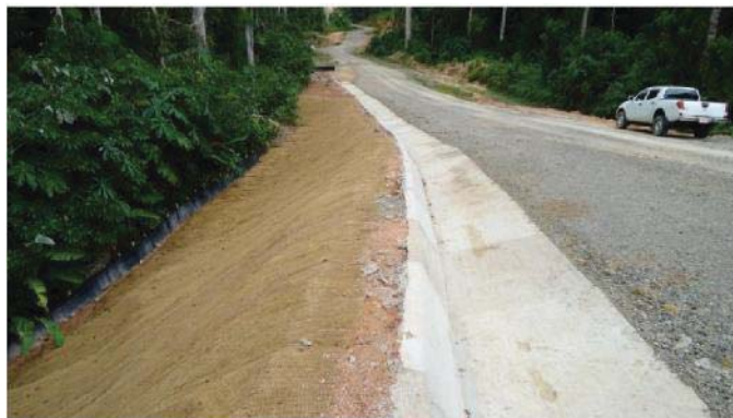
Photo 3. Création de talus, pose de la fibre de coco et construction de fossés de crête
