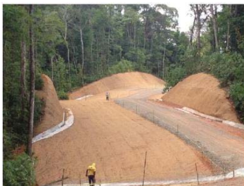
Photo 12. Pose de la fibre de coco, construction de fossés et pose d'une clôture anti-érosion
