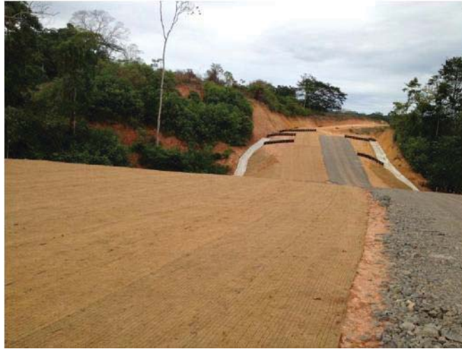
Photo 10. Création de talus, pose de la fibre de coco, construction de fossés, pose de ballast et pose d'une clôture anti-érosion
