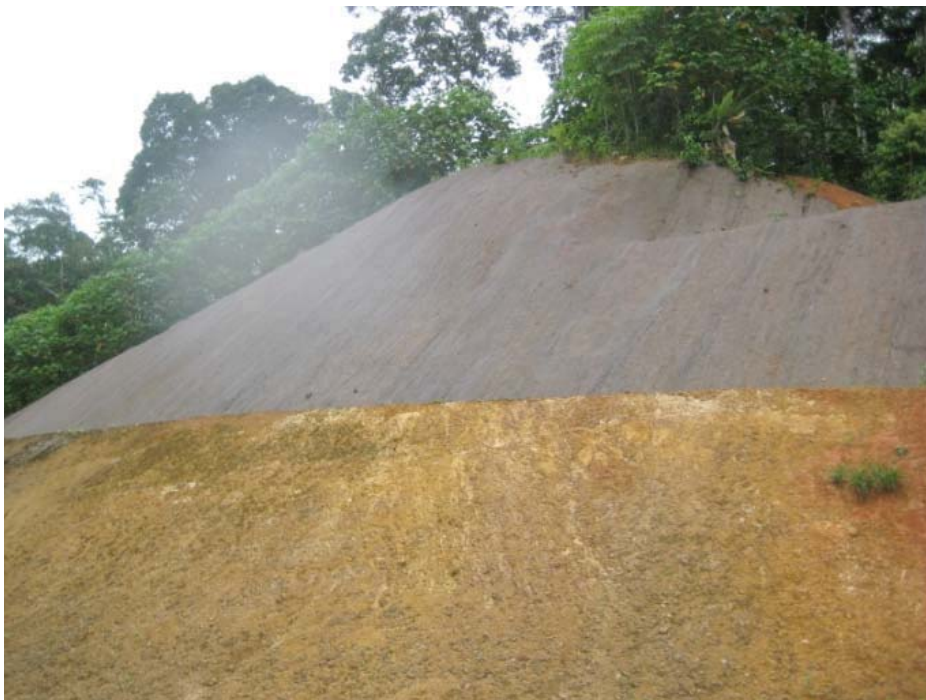
Pentes recouvertes d'une géomembrane afin de prévenir le ruissellement.
