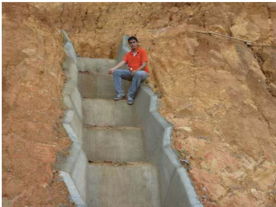
Canalisation étagée visant à réduire la vitesse des eaux de pluie.
