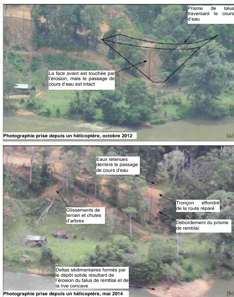
Figure 10 : Point d'érosion marquée n° 9.4, à 18 km en aval de la borne n° II. Vues aériennes obliques prises entre octobre 2012 (a) et mai 2014 (b).
