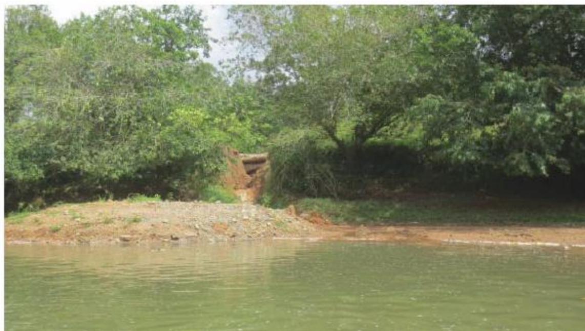
Photo 3 : Emplacement : KM 20,3 de la route (depuis le bateau, mai 2014). Section de route présentant un passage de cours d'eau inadapté, composé d'un pont en billes de bois, qui a étranglé l'écoulement de l'eau et créé un delta alluvionnaire dans le fleuve.
