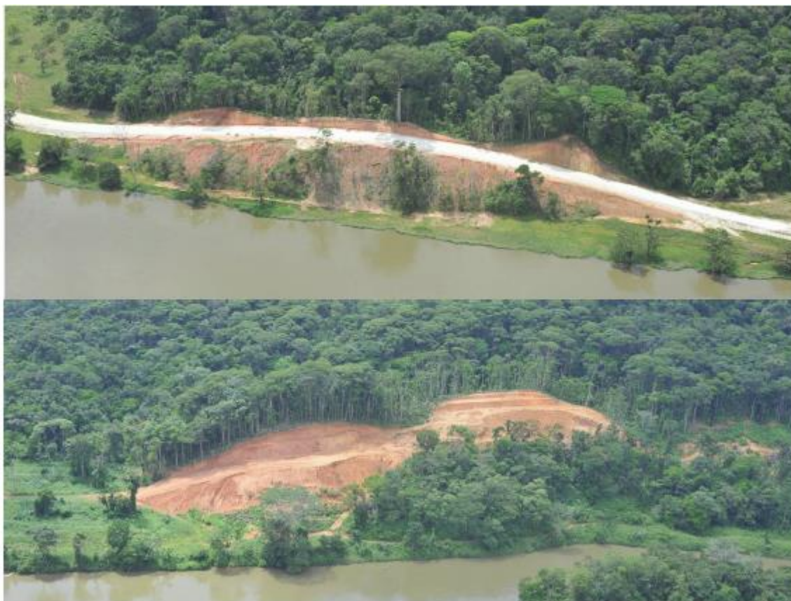
Figure 22 : Exemples de déplacement latéral du matériau de remblai. a) point d'érosion marquée n° 4 (entre les Rkm 8,2 et 8,7) (photographie prise depuis un hélicoptère volant au-dessus de la rive septentrionale du fleuve San Juan, octobre 2012). b) point d'érosion marquée n° 8 (entre les Rkm 16,1 et 16,4) (photographie prise depuis un hélicoptère volant au-dessus de la rive septentrionale du fleuve San Juan, octobre 2012). Le fait que les talus de remblai ne soient pas compactés et qu'ils aient été l'objet d'effondrements prouve que le matériau a été simplement poussé par les bulldozers au bas de la pente, ce qui a généré un amoncellement instable propice aux glissements de terrain, au ruissellement et au ravinement.
