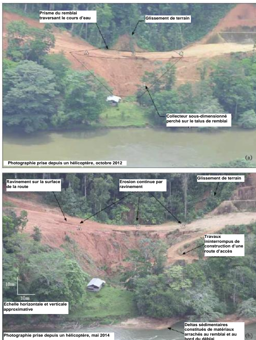
Figure 15 : Point d'érosion marquée n° 9.6, à 18,2 km en aval de la borne n° II. Vues aériennes obliques d'octobre 2012 (a) et mai 2014 (b).
