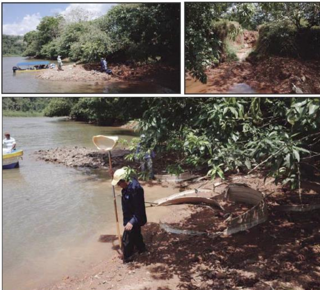
Figure 25 : Photographies prises pendant une visite sur le terrain effectuée en mars 2014 et montrant un delta sédimentaire — avec des débris du ponceau effondré — s’avançant dans le fleuve San Juan. Du nouveau matériau de remblai a été placé dans le chenal de manière à combler partiellement le vide créé par l’effondrement, mais aucun nouveau collecteur n’a été installé.
