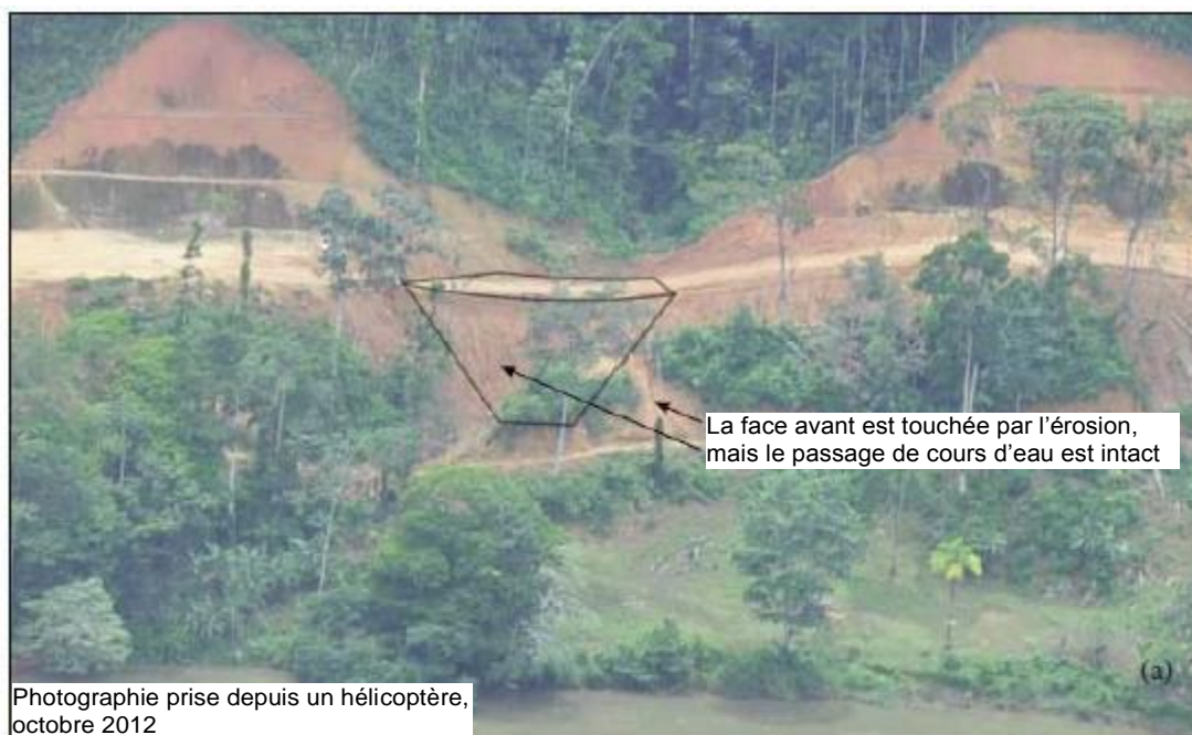
Figure 13 : Point d'érosion marquée n° 9.5, à 18,1 km en aval de la borne n° II. Vues aériennes obliques d'octobre 2012 (a) et de mai 2014 (b).
