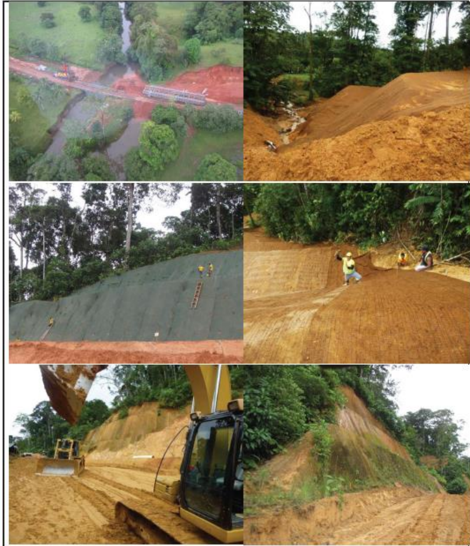
Figure 7.8 : Travaux de grande ampleur actuellement menés par le CONAVI en différents points proches du Cureñita, inspectés en novembre 2014. Photographies de l'auteur.
