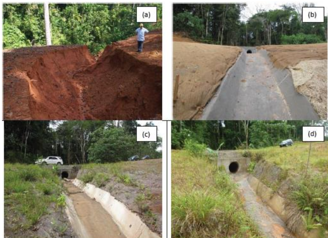
Figure 7.12 : Vue d'une large ravine formée dans un prisme de remblai par le ruissellement concentré de la route s'écoulant en territoire costa-ricien à l'ouest de la borne n° II ; a) en février, alors qu'elle se formait et b) en mai, après la mise en œuvre d'opérations de remblayage et de stabilisation au moyen d'un ponceau et d'un conduit bétonné, et la pose de nattes de fibre de coco pour protéger le talus de remblai avoisinant de l'érosion en nappe et de la formation de rigoles. Les photographies prises lors de visites ultérieures c) en avril et d) en août montrent que le ponceau installé au niveau du passage du cours d'eau est demeuré intact après la saison des pluies, et que la végétation a repoussé dans la zone avoisinante. Photographies de l'auteur.
