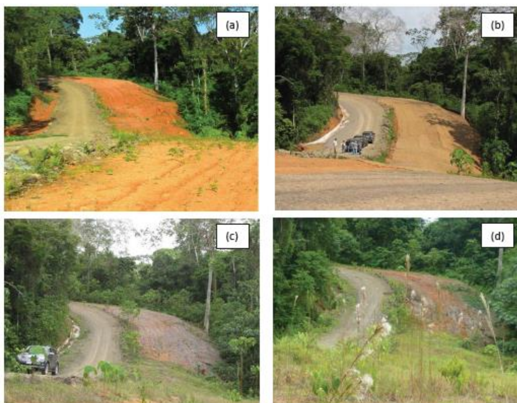
Figure 7.11 : La route près de la borne n° II a) avant les travaux d'atténuation le 15 février 2013 ; b) le 7 mai 2013, alors que les mesures étaient mises en œuvre, où l'on remarque la présence d'une conduite d'évacuation intérieure et de nattes anti-érosion biodégradables posées sur une large surface de terrain ; c) le 23 avril, où l'ensemble de ces mesures ont résisté à la saison des pluies, et d) le 29 août, où l'on voit que la végétation a permis de stabiliser les deux bordures de la plate-forme de la route et s'étend sur les zones recouvertes de fibre de coco. Photographies de l'auteur.
