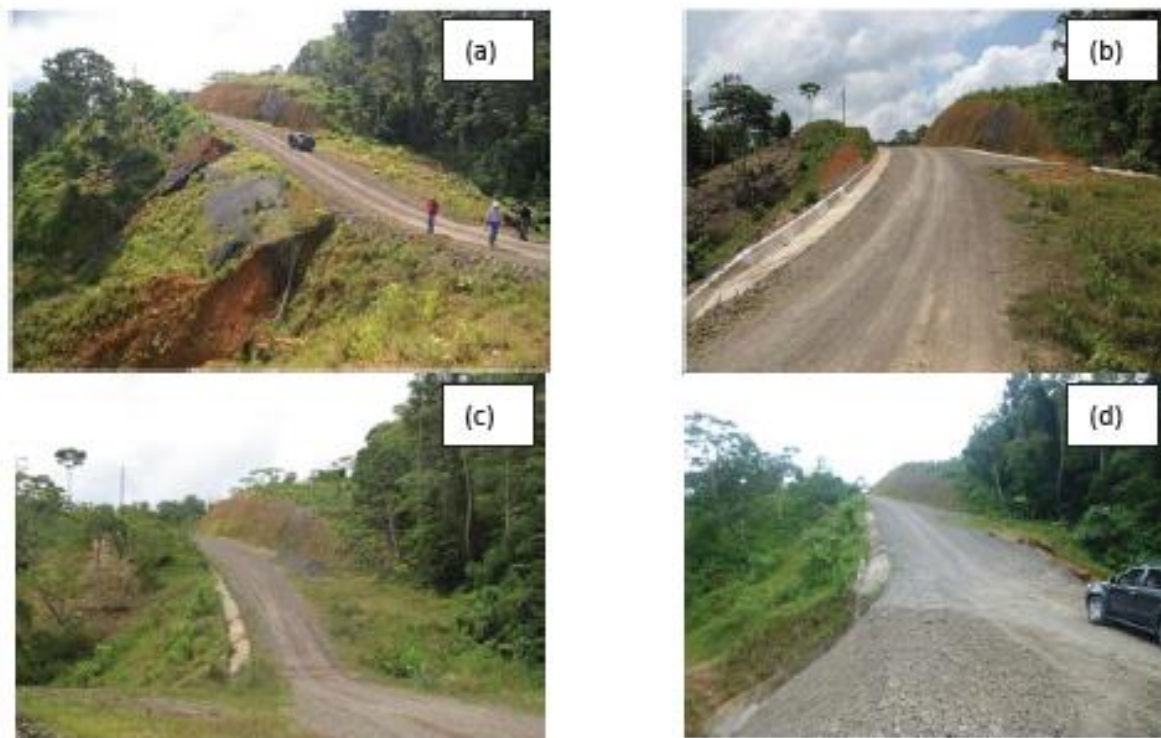
Figure 7.13 : Photographies de la route au point 49^{\circ} 78' 67'' de latitude est et 32^{\circ} 54' 63'' de longitude nord, à 6,4 km environ à l'est de la borne n° II a) le 15 février, où, suite à la rupture d'une protection géotextile du talus, le ruissellement concentré extérieur de la route avait entraîné la formation de deux ravines, et le ruissellement intérieur avait fragilisé un talus de déblai ; b) le 7 mai 2013, après la construction de fossés bétonnés extérieur et intérieur ; c) et d) en 2014, où l'on voit que l'érosion a été effectivement atténuée, avec la résorption des ravines et la repousse de la végétation sur les talus de déblai et de remblai. Photographies de l'auteur.
