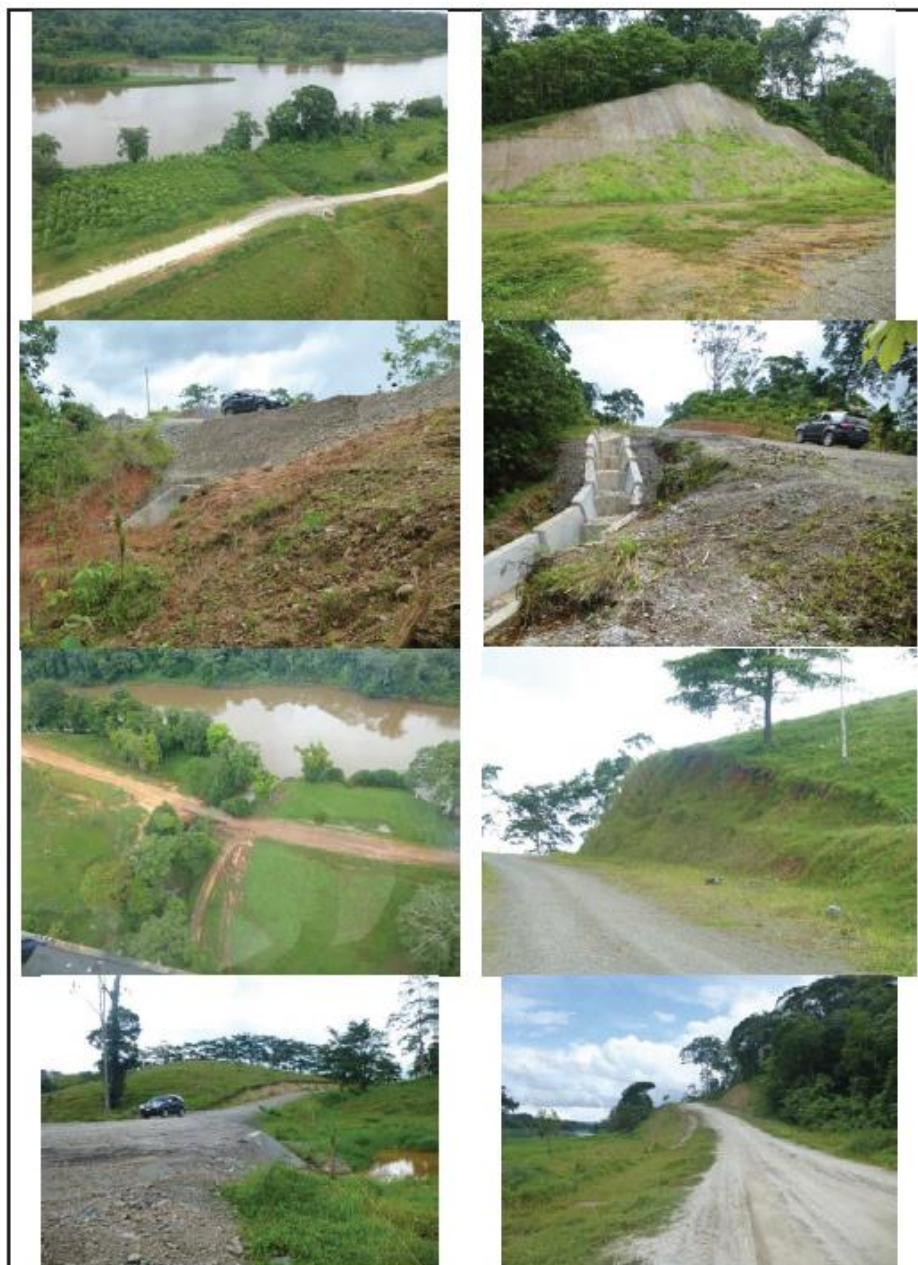
Figure 7.7 : Etat d'avancement d'autres travaux d'atténuation de l'érosion réalisés par le CONAVI, inspectés par l'auteur en 2014 (passages de cours d'eau à gauche, et talus à droite). Photographies de l'auteur.
