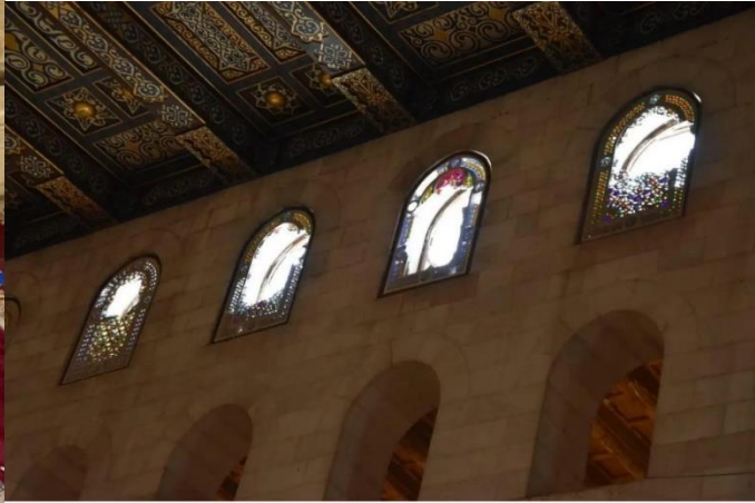
التعليق: تعدد القوات الخاصة بتكسير وتدمير معالم المسجد الأقصى المبارك ومن ضمنها تكسير 29 شباك جصي تاريخي داخلي وخارجي من الشبائيك الغربية الحصينة التاريخية للمسجد القبلي في المسجد الأقصى المبارك. المكان: المسجد القبلي. التاريخ: 15.04.2022، صباحاً. المصدر: دائرة أوقاف القدس وشؤون المسجد الأقصى المبارك.
